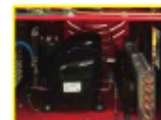
Double fan & compressor
